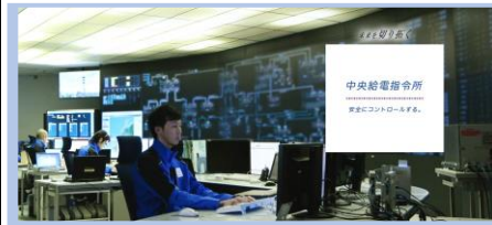
需給バランスを調整し、電気をコントロールする指令所
